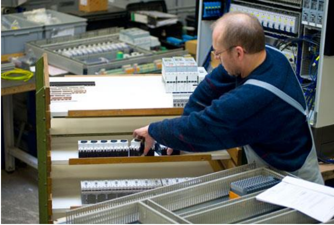
Montage mit Stückliste: Welches Bauteil wohin gehört, steht zurzeit noch auf Papier. Bald projiziert ein Beamer jedes Teil direkt auf den Schaltschrank. (Foto: Schubs GmbH)
