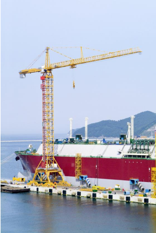
Turmdrehkran im XXL-Format: Der 4000 HC 100 der Firma Liebherr kann bis zu 100 Tonnen schwere Schiffsbauteile heben. (Foto: Liebherr)
