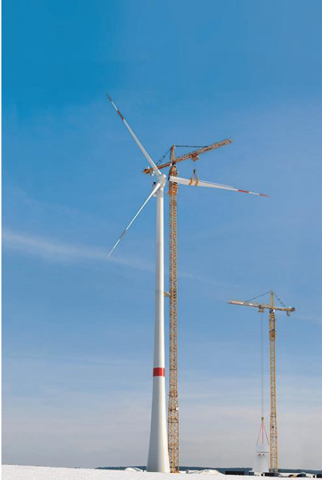
Auch um Turmdrehkräne geht es bei dem Branchentreffen: Das Foto zeigt zwei Liebherr 630 EC-H 70 Litronic bei der Montage von Windenergieanlagen. (Quelle: Liebherr-Werk Biberach GmbH)
